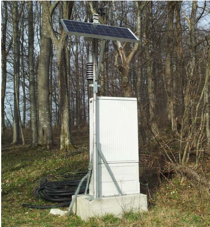
Autarke Station für die messtechnische Überwachung von Hangbewegungen.
